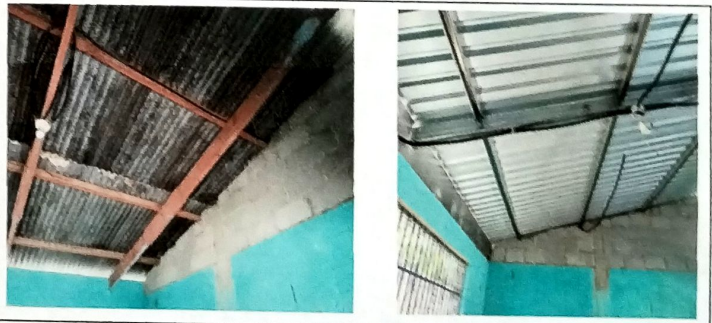
Foto 10: Vista Interior de Modulo de aulas B se cambio cubierta de lamina de zinc por lamina troquelada cal 26. Se sustituyo estructura de madera en mal estado por estructura de metal a base de vigas y costaneras .
