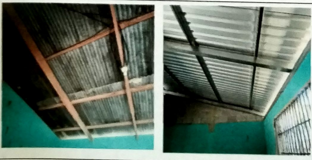
Foto 11: Vista Interior de Modulo de aulas B se cambio cubierta de lamina de zinc por lamina troquelada cal 26. Se sustituyo estructura de madera en mal estado por estructura de metal a base de vigas y costaneras .
