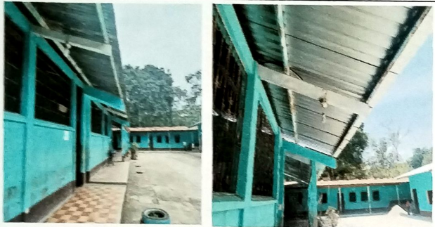
Foto 7: Vista Exterior Corredor de Modulo de aulas C se cambio cubierta de lamina de zinc por lamina troquelada cal 26.
