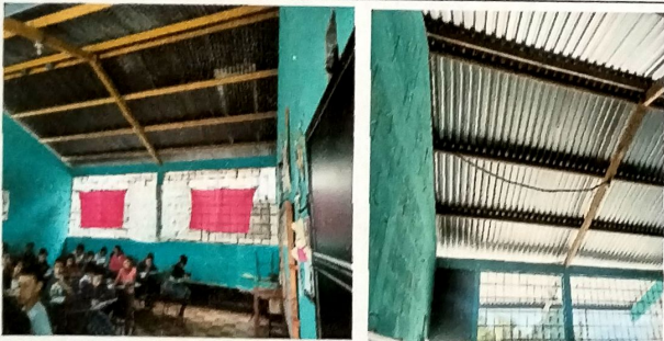
Foto 3: Vista Interior de Modulo de aulas C se cambio cubierta de lamina de zinc por lamina troquelada cal 26.
